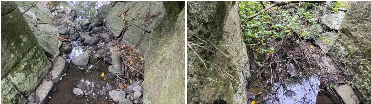
Figur 48. Delvis raserat brofäste på sträcka 34 vid Stävesjö. Stenarna från det delvis raserade brofundamentet tillsammans med träd och kvistar i ån kan utgöra partiellt vandringshinder för öring och definitivt hinder för mört vid lågflöde.
