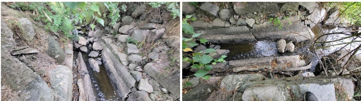
Figur 50. Delvis raserat brofäste på sträcka 13 vid Källstorp. De raserade stenarna i ån kan utgöra partiellt vandringshinder för mört vid lågflöde.
